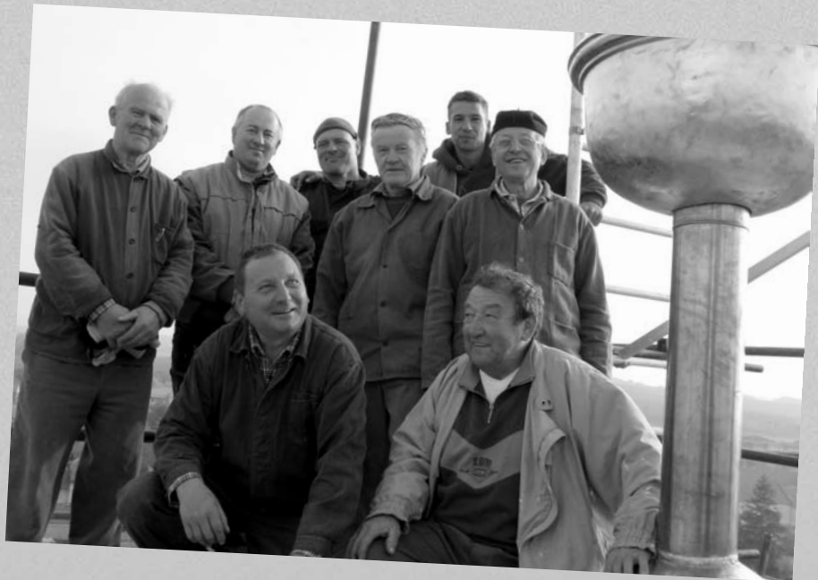
Na rekonstrukci věže dřevohostického kostela se podíleli: zleva Adolf Štěpáník, tesař Robert Tuček, Jiří Kasperlík, Josef Kužel, Robin Zehnálek, Josef Hradílek, vpředu Antonín Čápík a Adolf Vašina.
